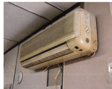
施工して15年以上経過した〈エコ・クイーン〉壁とタバコのヤニですっかり汚れてしまったエアコン。
